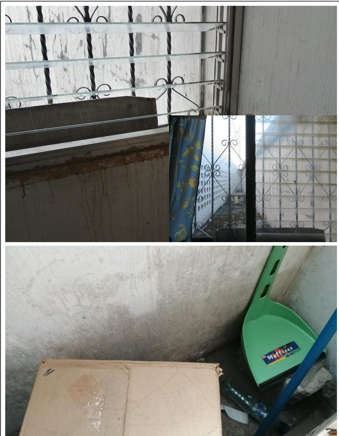
Imágenes 22 y 23. Marcas de humedad en la parte inferior y en la pared que la sustenta evidencia la presencia de agua de lluvia que se escurre. De lo anterior, el potencial riesgo para los documentos instalados en los platos inferiores y los documentos situados en el suelo, ante la posibilidad de lluvia continua. Se advierten soluciones improvisadas para contener o intentar desviar la mayor cantidad de agua.
