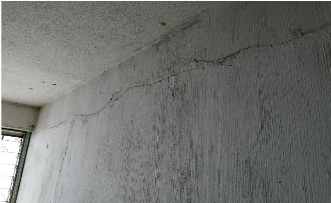
Imágenes 17 y 18. El área de depósito de los documentos evidencia ligeros daños provocados por los movimientos telúricos.
